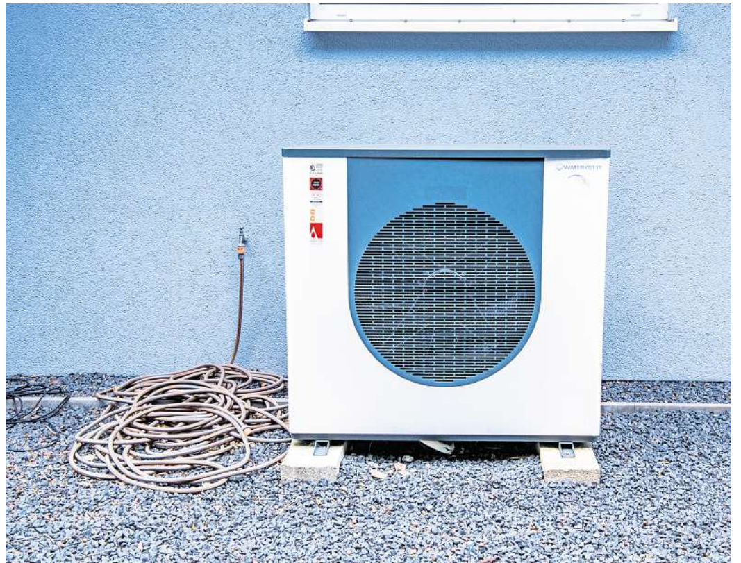
Moderne Wärmepumpen sind leiser als früher: Mit unter 50 Dezibel arbeiten sie so leise wie ein Geschirrspüler.
