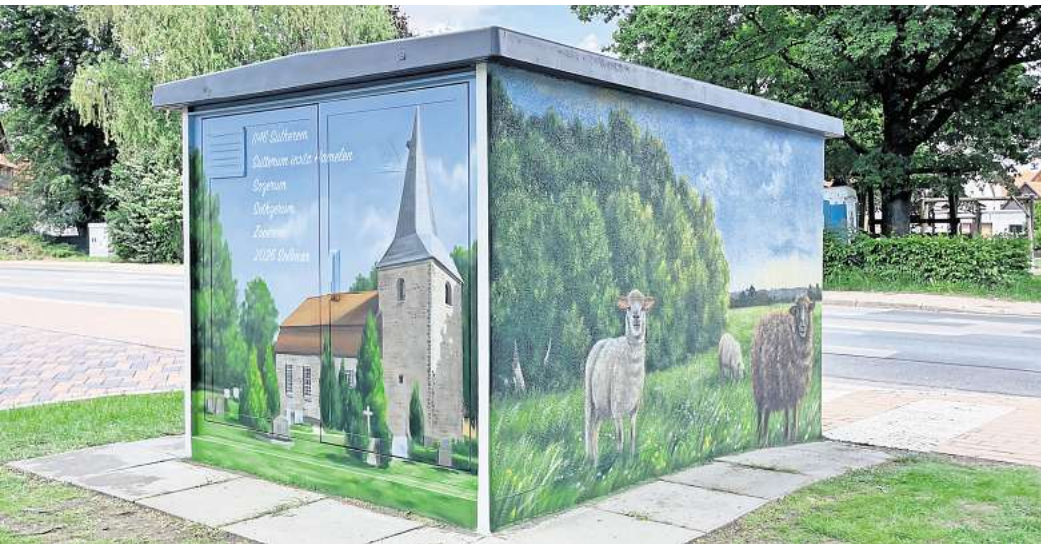
Bunte Gemälde aus dem Dorfleben zieren jetzt die Trafostation an der Jägerstraße in Soßmar. Foto: Avacon
