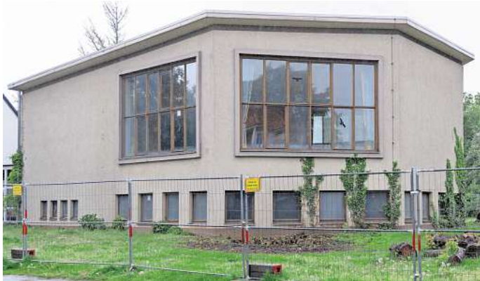
Die Arbeiten haben begonnen: Die Stadt Salzgitter lässt die Aula der Grundschule St. Michael umbauen zu einer „Gemeindebedarfseinrichtung“.
