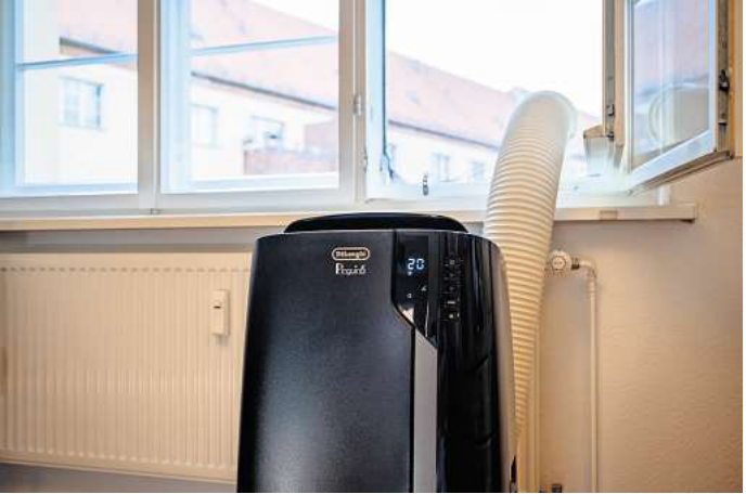
Achtung: Unterdruck! Der Abluftschlauch eines mobilen Klimageräts gehört durchs Fenster - am besten gut abgedichtet, etwa mit einer Acrylglasscheibe samt Loch für den Schlauch. Foto: Nico Tapiá/dpa-mag
