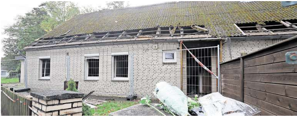
Inzwischen sind auch Bauzäune aufgestellt: Über den Umgang mit den asbesthaltigen Dachplatten beim Wohnhausbrand in Triangel ist nun ein Streit entbrannt.
