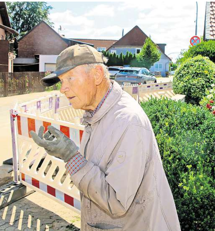
Großes Loch in Rötgesbüttel: Genau vor Otto Bertrams Grundstück brach die alte Asbestzement-Leitung unter der Dorfstraße. Foto: Gero Gerewitz
