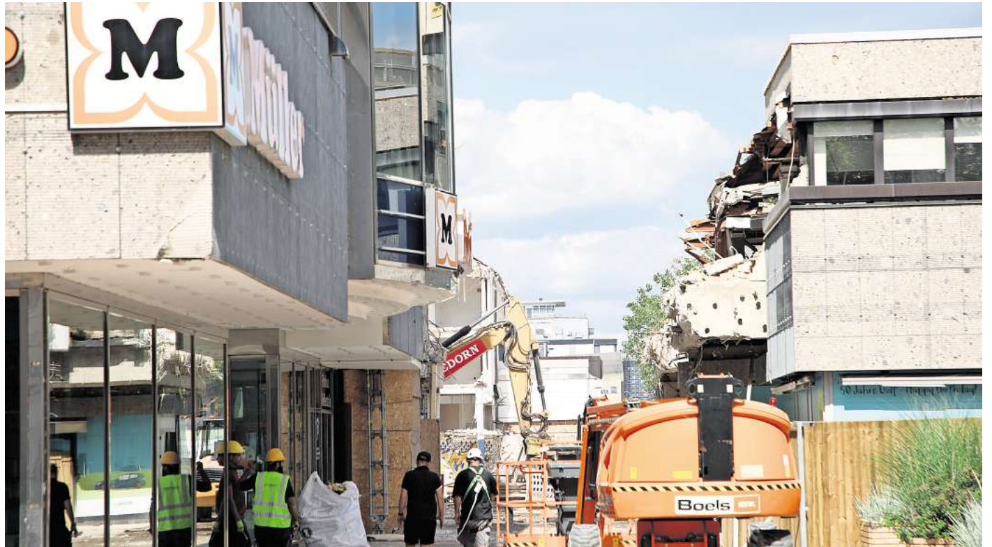
Da klafft die Lücke: Die Verbindung zwischen dem Pavillon und dem Geschäftsgebäude ist komplett abgerissen.
