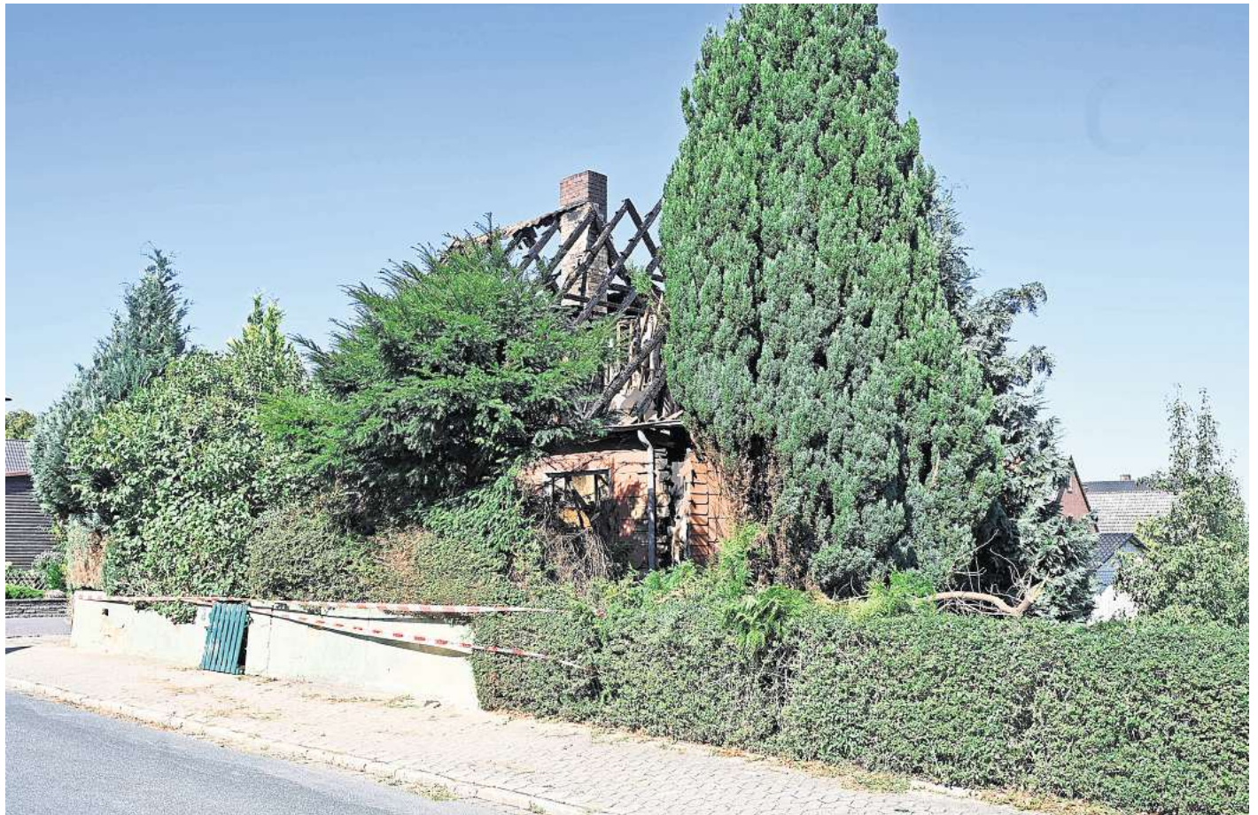
Das leerstehende Haus an der Straße „Zum Luhberg“ ist komplett ausgebrannt.
