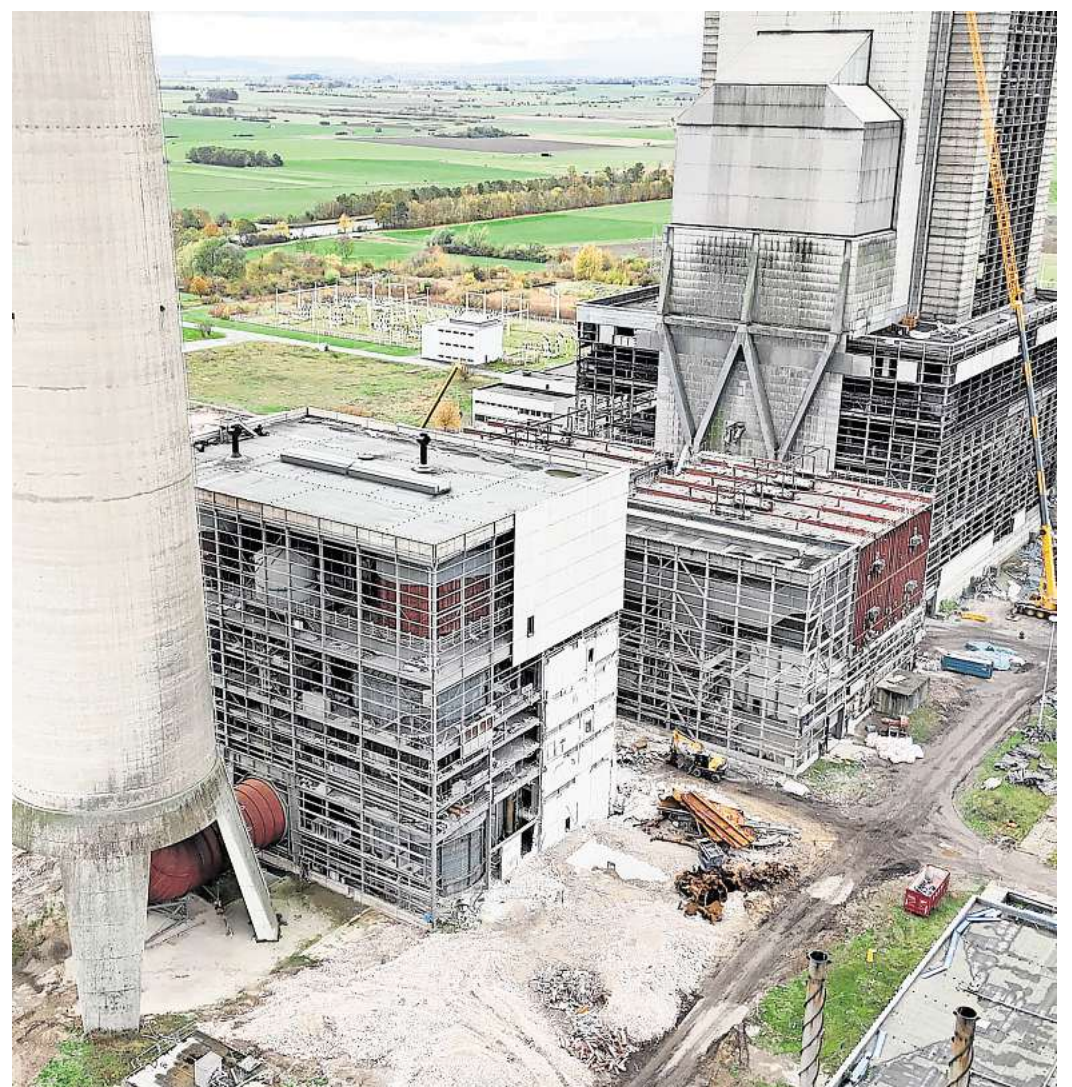
Der Rückbau des Kraftwerks Mehrum geht weiter: Nachdem fast alle asbesthaltigen Fassadenplatten entfernt wurden, sind Stahlgerippe zu sehen.
