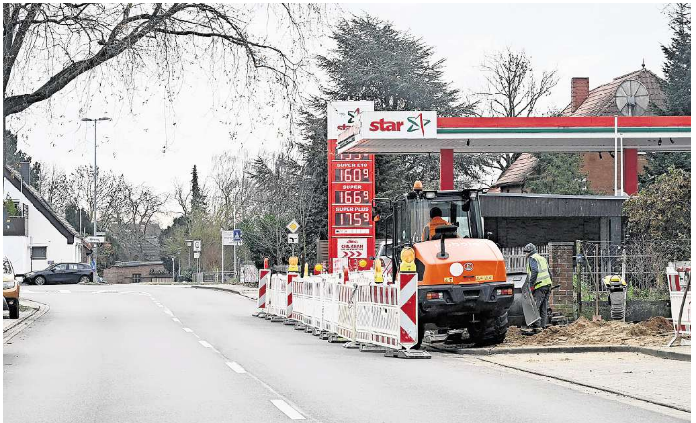
In Vöhrum verlegt derzeit die Telekom Glasfaser – hier an der Burgdorfer Straße.
