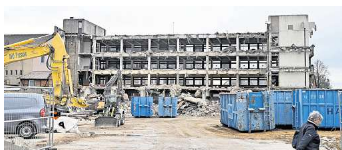
Abriss: Blick in das Innere des alten Postgebäudes an der Schützenstraße in Peine. FOTO: RALF BÜCHLER
