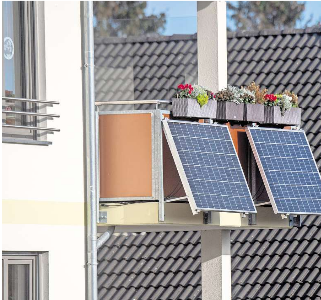
Ein Balkonkraftwerk muss bei der Bundesnetzagentur angemeldet werden. FOTO: STEFAN SAUER/DPA/DPA-MAG
