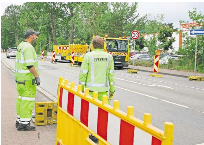
Am Montag hat die Einrichtung der Baustelle zwischen der Kreuzung Kaufland/Hagebau und der Einmündung Weißdornbusch/B4-Brücke begonnen.
