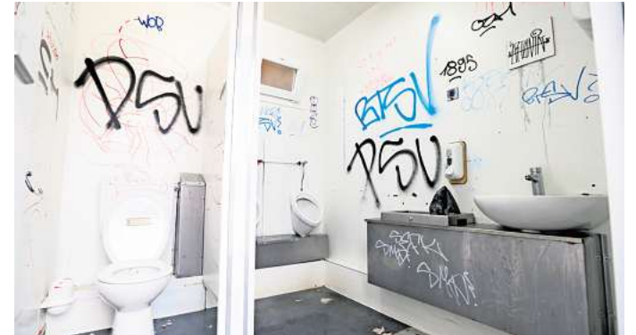
Alltägliche Zerstörungswut: Kaum gereinigt, sieht die Toilette im Bahnhof Gifhorn Stadt schnell wieder so aus.
