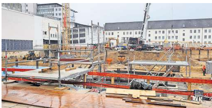
Im April sollen der Hochbau für die Brawo-Arkaden im Erdgeschoss angekommen sein.
